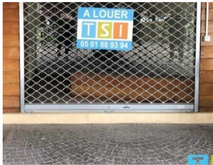
Local non accessible pour les PMR (marche)
