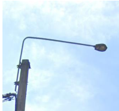
Lanternes routières RD
